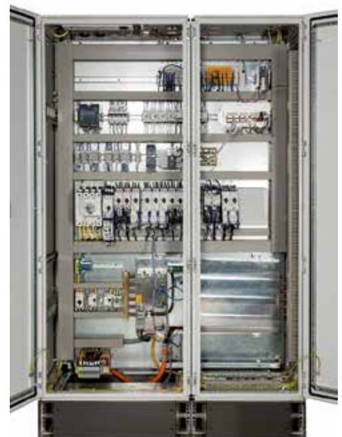
Im Schaltschrank des modernisierten Stanzautomats sind die Servoverstärker übersichtlich montiert.
